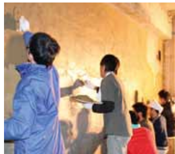
拠点の「フラットビル」の改修活動もワークショップに。土壁を自分たちで塗っている様子
