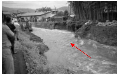
井の口川護岸崩壊と復旧状況 【平成 2 年 9 月 17 日 台風 19 号】
