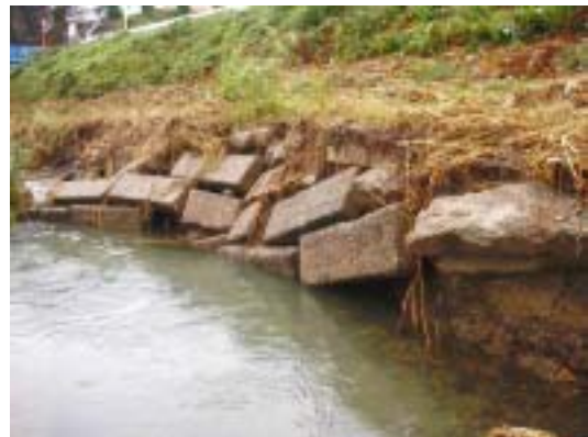
護岸の被災状況 (H16年 台風23号、明神橋下流左岸)
