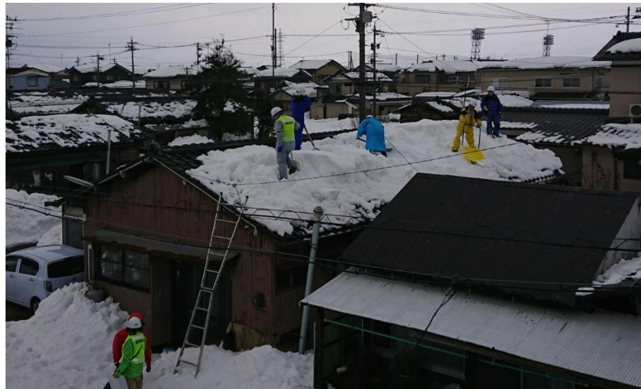
あわら市市姫(市営住宅の屋根雪おろし)
